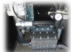
Pompa alta pressione
